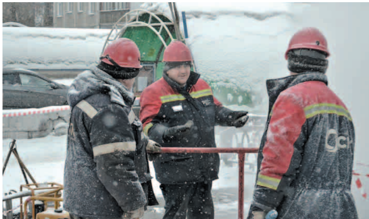
Причина зимних ремонтов — изношенность теплосетей.
